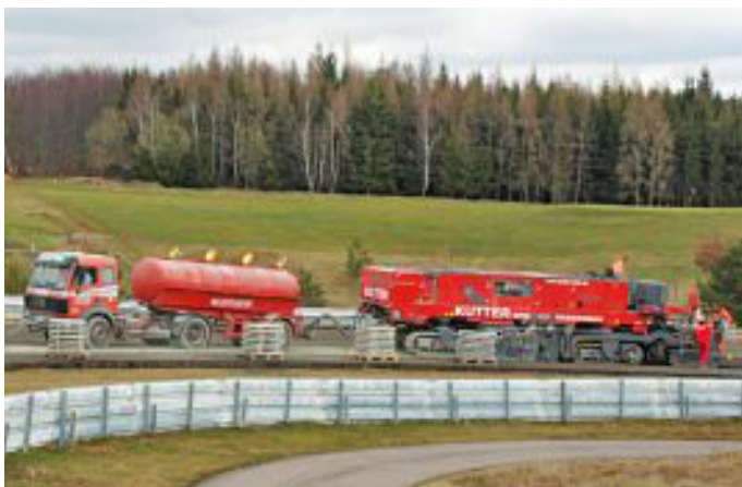
Unterbau einer Rennstrecke: Die alte Fahrbahndecke wurde gefräst und nun mit Fehlkörnung, Bindemittel und Schaumbitumen in eine hoch belastbare Tragschicht verwandelt.
